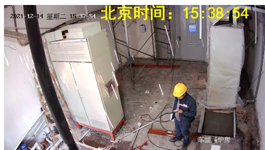
图 6 梁某昌引发火灾的 焊渣溅落画面
